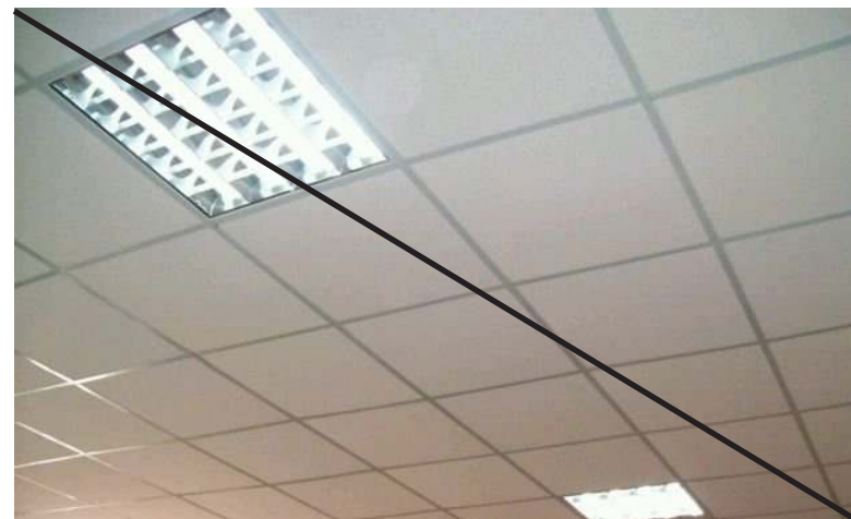
Плохо Открытые направляющие
